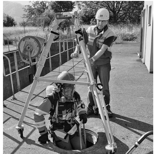
Bild 1: Beim Einsteigen in einen Schacht ist Alleinarbeit verboten. Denn im Notfall (Ersticken Gefahr!) ist sofortige Hilfe nötig. Die einsteigende Person muss dauernd von einer zweiten Person überwacht werden (Richtlinie 1416.d).
